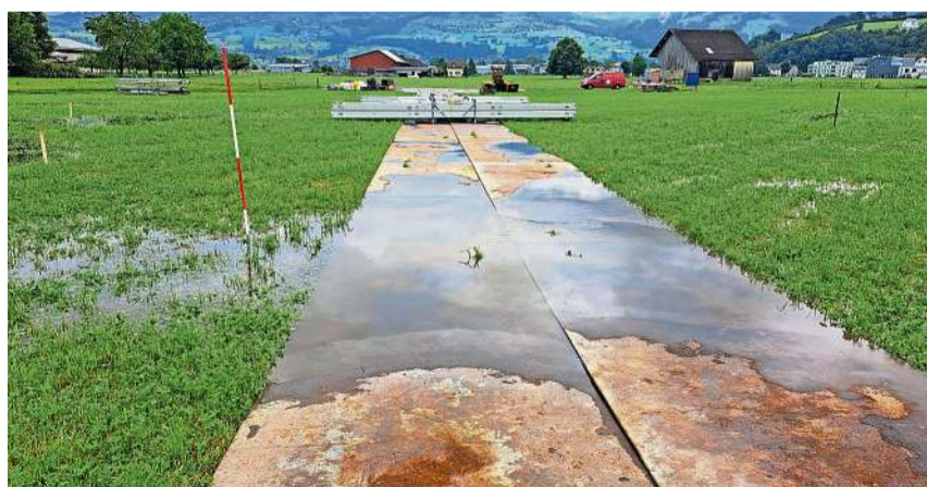
Vor dem Aufbau musste zuerst das Wasser aus den Wiesen gepumpt werden.
